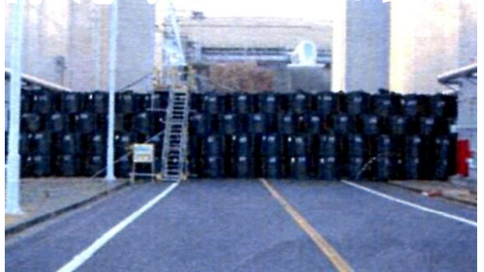
写真は新たに作られた浸水防潮堤。土嚢を数段積んだだけでは津波対策にはならないのでは？ ＝東電提供資料から
