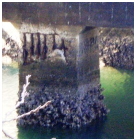
中区大岡川に架かる築84年の宮川橋。橋脚の鉄骨が腐食している。＝2月2日撮影
