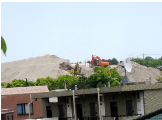
問題の建築破砕材会社。廃材が積み、粉じんの原因となっています。＝2012年5月、横浜市旭区
